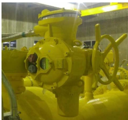
Les servomoteurs Bernard Controls ont été peints en jaune sur demande du client
